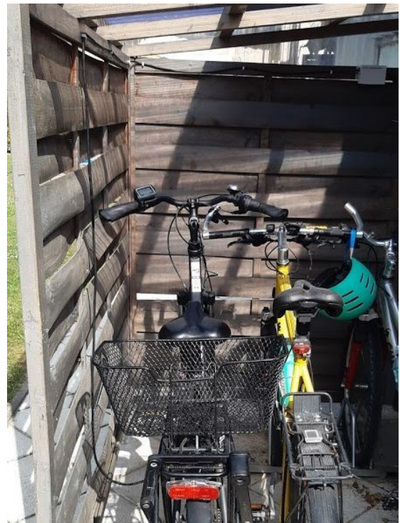
Bild 5: Das Solarmodul ist auf dem Dach des Fahrradabstellplatzes montiert, der DC/DC-Wandler unter dem Dach (oben rechts im Bild) und das Ladekabel so lang, dass es vom Wandler bis direkt an das E-Bike reicht
